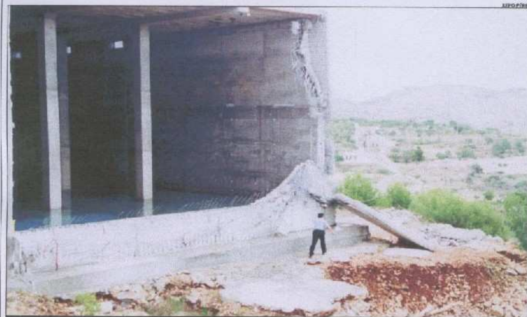
Imagen de la pared derrumbada del depósito de agua que provocó una avalancha de hasta 4.000 m 3 y que ocasionó importantes daños en Benissa
